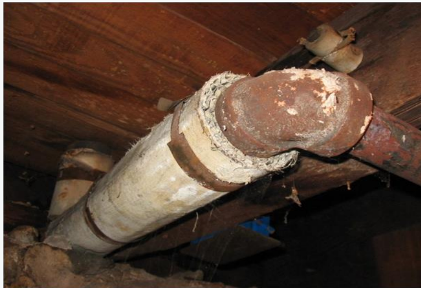
Azbestová izolace potrubí
