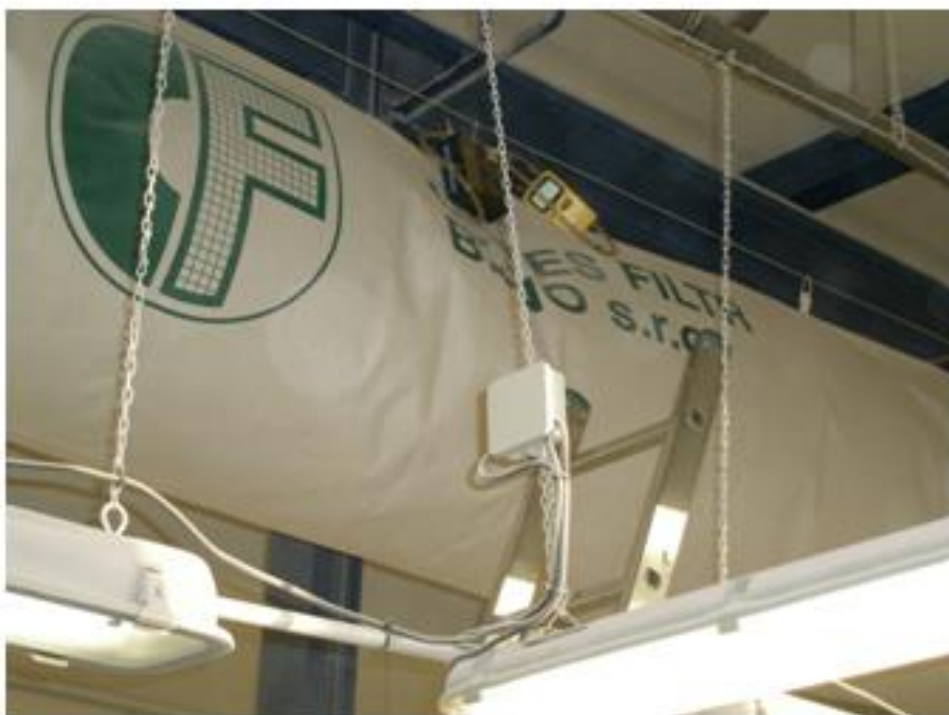
Umístění odběrových aparatur v těsné blízkosti přívodu vzduchu
