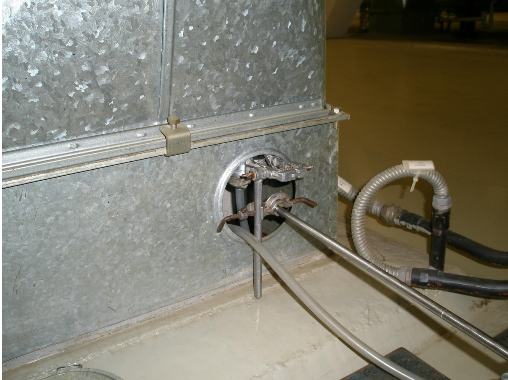
Umístění odběrové sondy za filtrační jednotkou ve výduchu do výrobní haly v protipožární klapce
