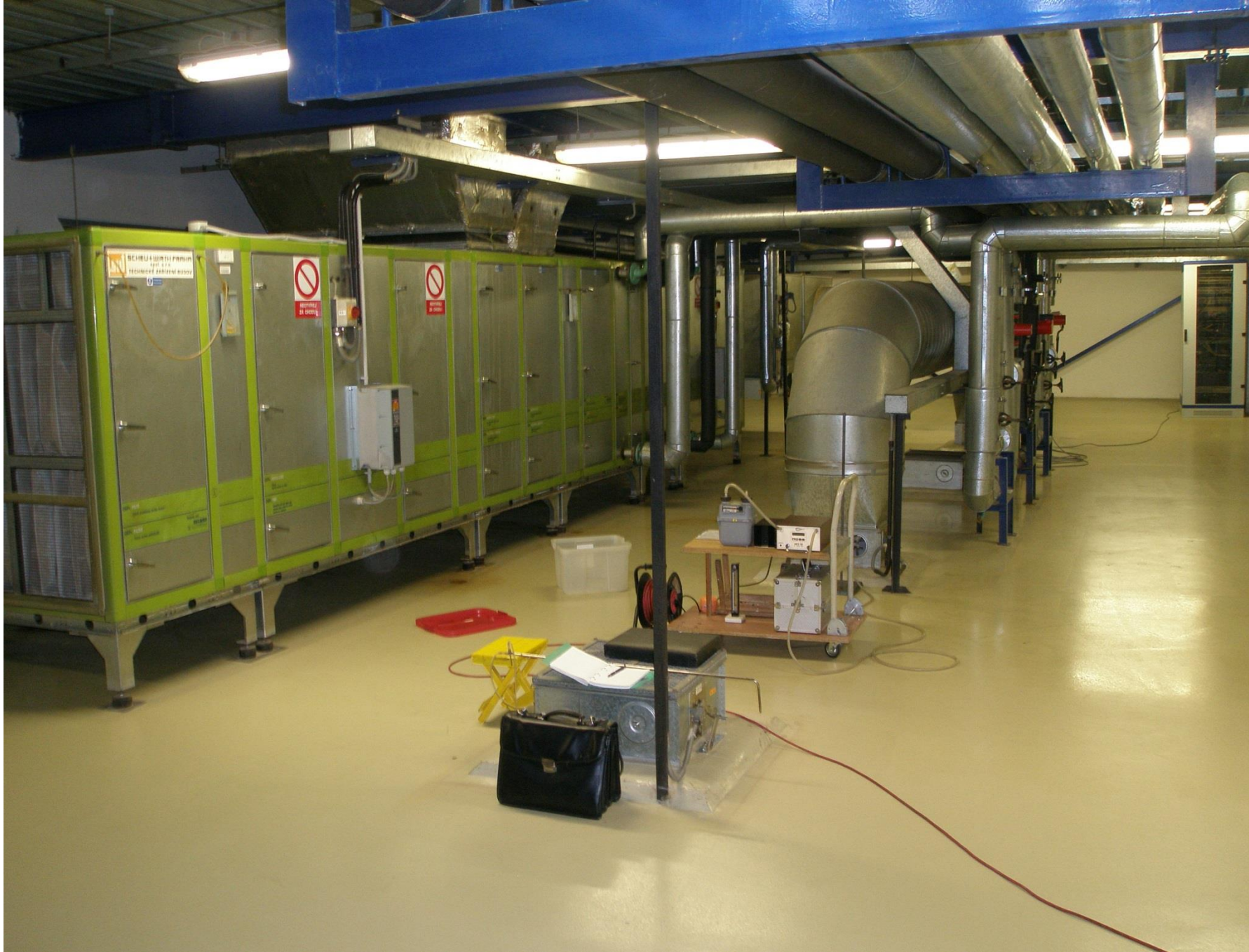
Celkový pohled na filtrační jednotku AHU 9 a odběrovou aparaturu
