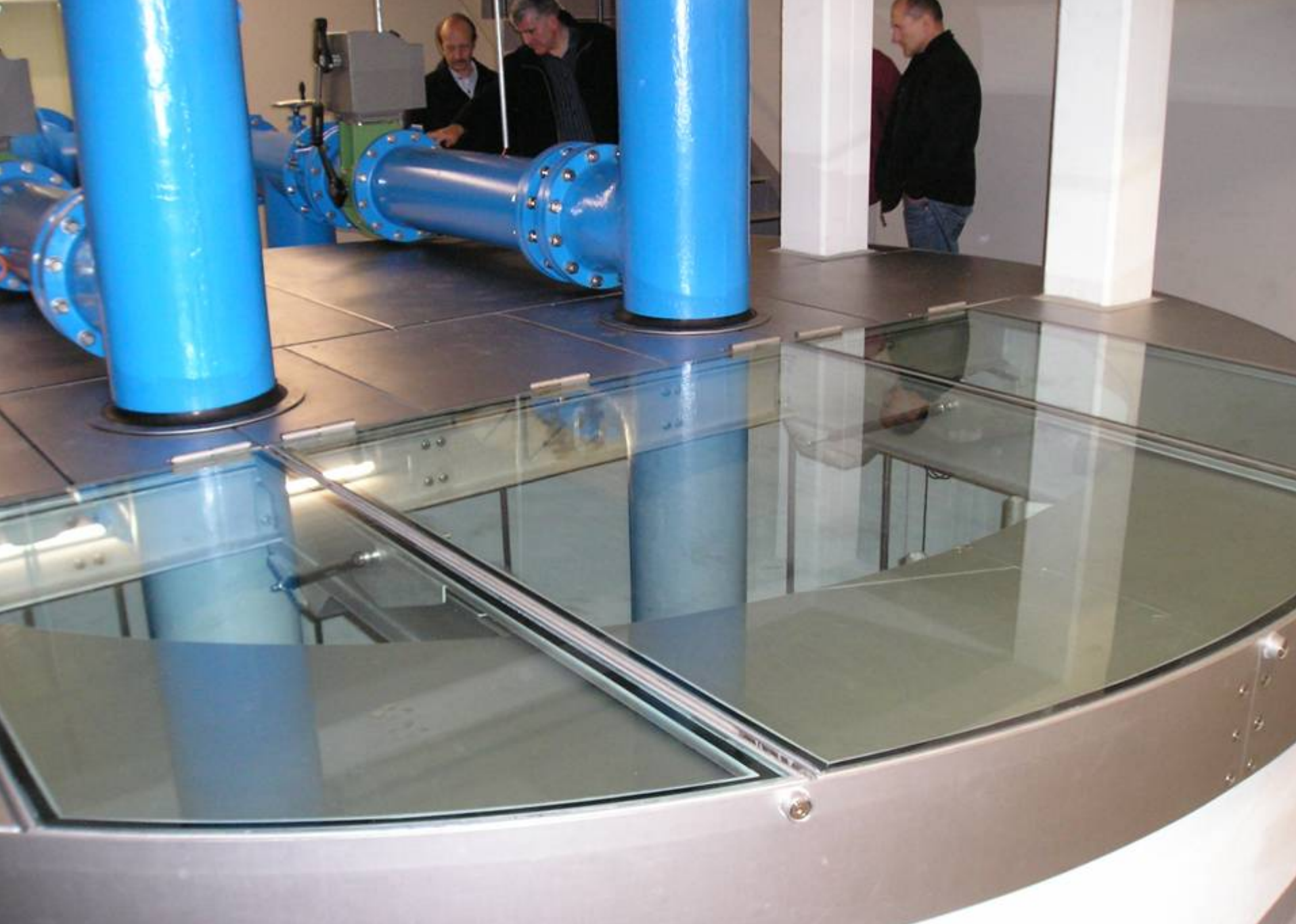
Moderní úprava zhlaví vrtu u jednoho zdroje vodovodu ve Winterthuru. Prostředí je udržováno v téměř dokonalé čistotě.
