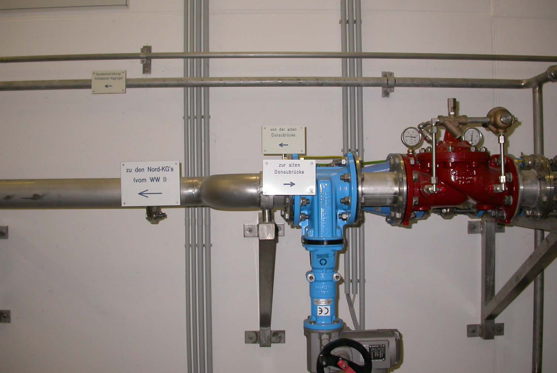
Označení jednotlivých potrubí na novější úpravně vody (II) na severním břehu Dunaje.
