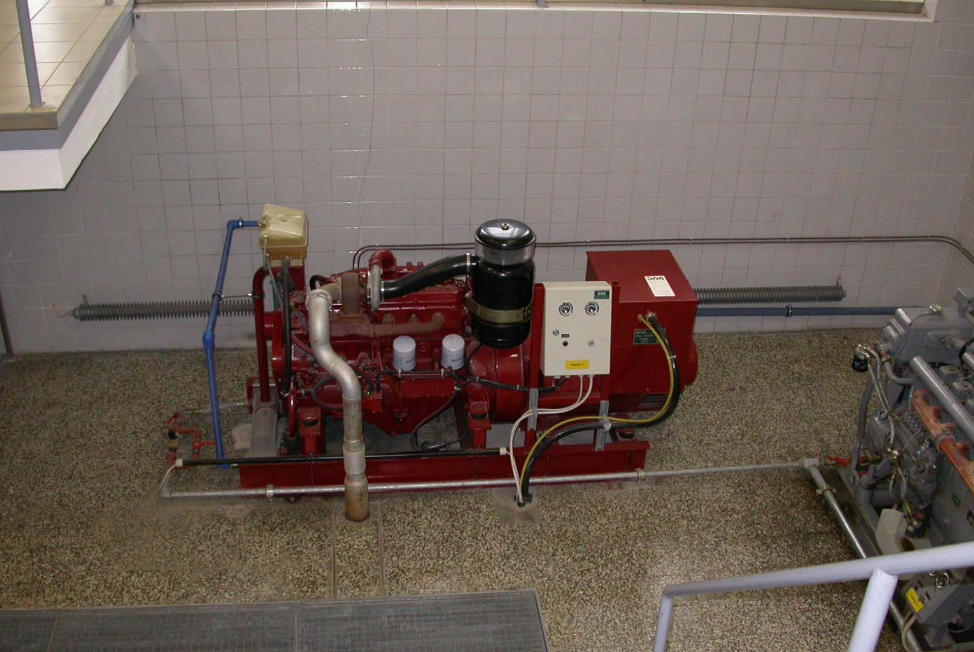
Náhradní agregát pro případ výpadku elektrického proudu na úpravně (I).
