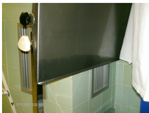
Obr. 4: Zakrytá odváděcí vyústka
